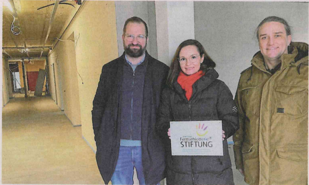
Die DRK-Vertreter Maik Fedeler (Geschäftsführer), Marina Hesselting (Mitglied der Geschäftsleitung/Prokuristin) und Frank Woltering (stellvertretende Sachgebietsleitung Seniorenhilfe, v.l.) in dem Gebäudeteil, in dem künftig die Tagespflege untergebracht sein wird.
